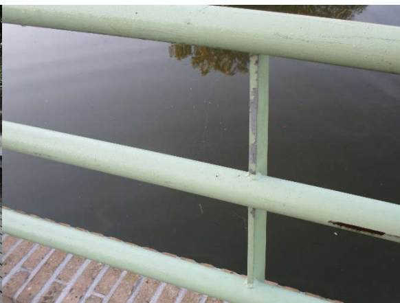
Kunstwerk: Halbrug KW021 en Gemeentevijver kade KW065. Het vervangen van de conservering van het stalen leuningwerk staat in 2023 gepland. Globale kosten € 16.000.
