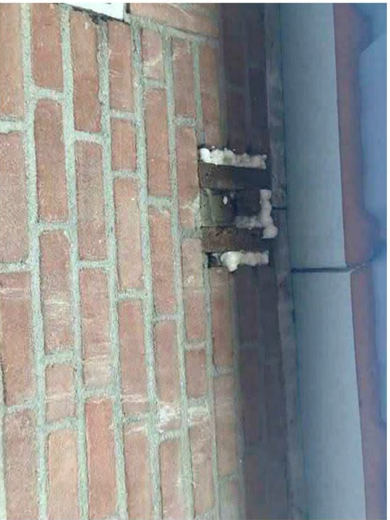
• Afbeelding 24: gaten in de gevel dicht gepurd om kauwen te weren
